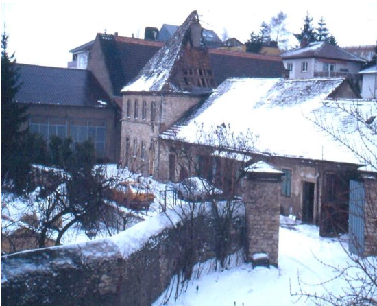
1987, das Dach des Haupthauses ist eingestürzt. 63
