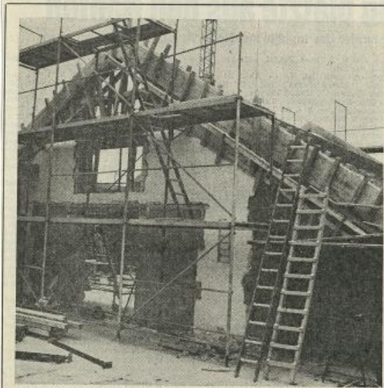
DIE ARBEITEN am Erweiterungsbau der Friedhofskapelle in Nieder-Olm sind voll im Gange. Bis zum Sommer soll die Maßnahme abgeschlossen sein. In der jüngsten Ortsgemeinderatsitzung wurden weitere Arbeiten in Höhe von insgesamt 67 000 Mark vergeben. Mit diesem Geld können nun die Dachlöcher-, Zimmer-, Spengler- und Installationsarbeiten durchgeführt werden. Bereits im Haushaltsjahr 1980 waren im Gemeindefiskus 50 000 Mark zur Verfügung gestellt worden. Im laufenden Haushaltsjahr sind nochmals 285 000 Mark eingeplant, die über eine Darlehensaufnahme finanziert werden. Bild: PKS
